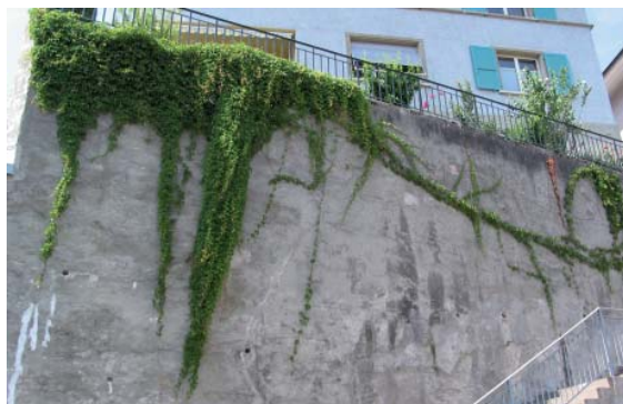
grand mur colonisé par la végétation
