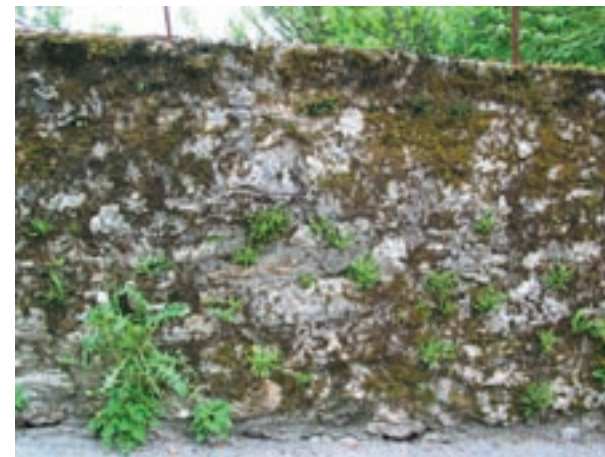
mur colonisé par des capillaires rouges
