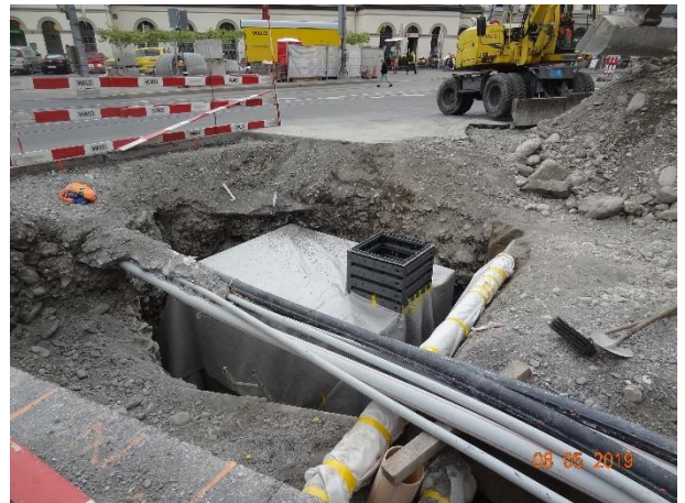
Versickerungsanlage mit Retentionsvolumen
