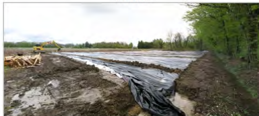
Mise en place de matériaux terreux sains sur les recouvrements de bâches, mi-avril 2012
