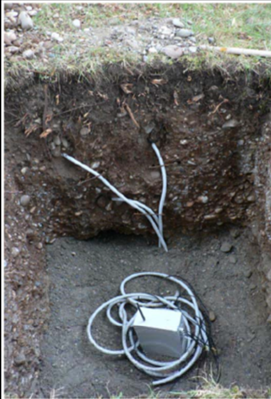
Abb. 3: Sonden nach der Installation in der Profilwand und Gehäuse mit Datenlogger und Modem.
